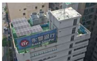
永豐銀行北高大樓太陽能板光電系統
